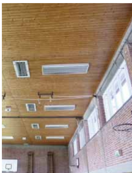
Blick in die Turnhalle St. Josef - heute noch mit erdgasbetriebenen Deckenstrahlern beheizt
